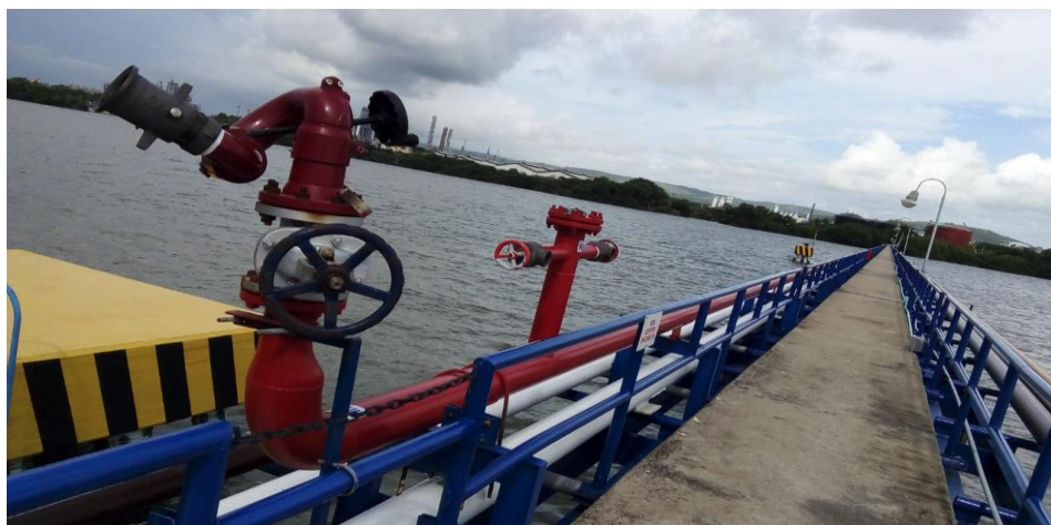
Figura 3. Características de la pasarela con los siete (7) sistemas de tuberías de cargue y/o descargue de DEXTON S. A.
